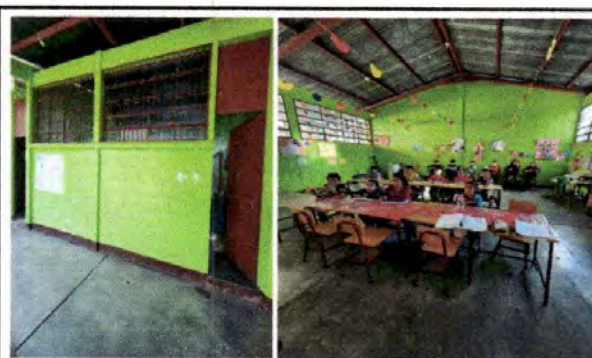
Foto 10 : Pintura en muros exteriores, interiores
